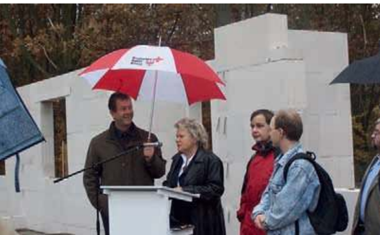
Bild oben: Auszug aus der Zeitung vom DRK Kreisverband Bild oben rechts: Baubeginn Bild mitte rechts: Grundsteinlegung Bild unten rechts: Grundsteinlegung Bild unten: Grundsteinlegung
